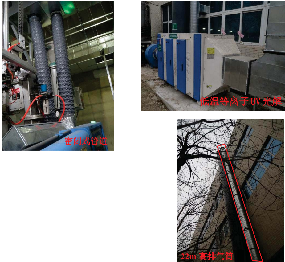
图 4-2 注塑废气处理设备现场照片
