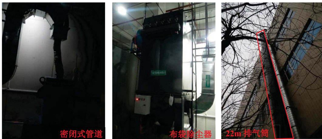
图 4-3 粉碎废气处理设施现场照片
